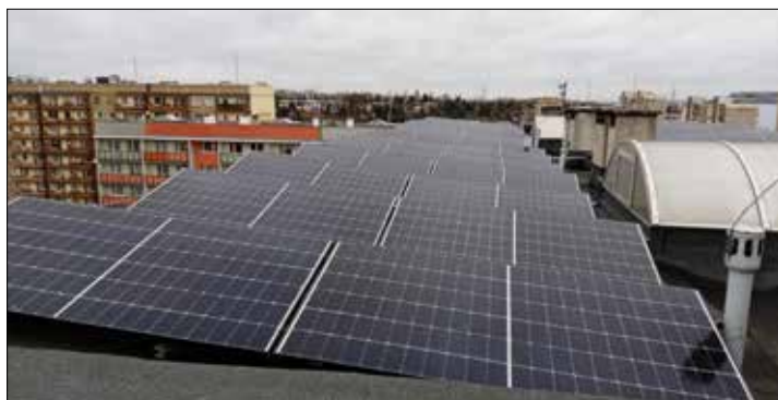
Instalacja fotowoltaiczna na Modrzewiowej 24B-C
