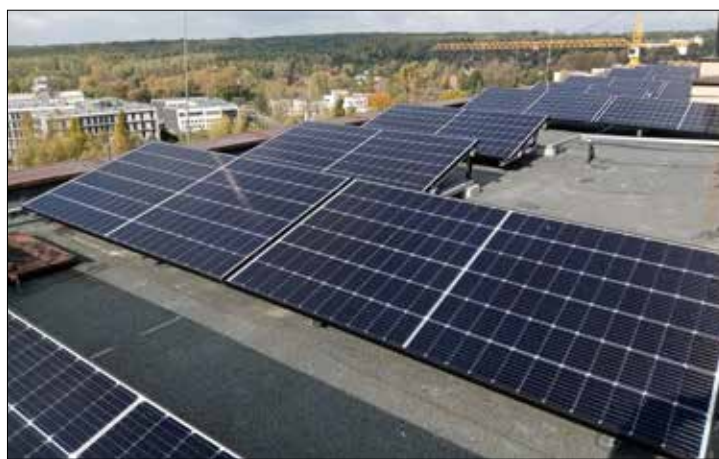
Panele na dachu budynku przy ul. Ligockiej 70
