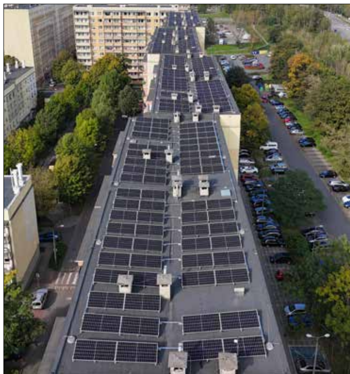
Instalacje fotowoltaiczne założone na budynku - ul. Lubuska 7-21
