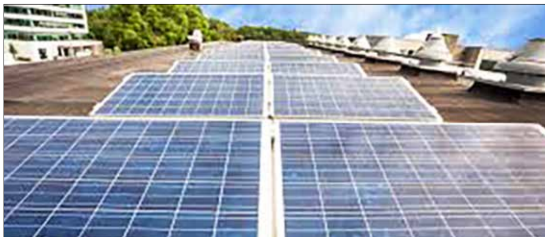
Instalacje PV zagospzczą niedługo na dachach budynków KSM
