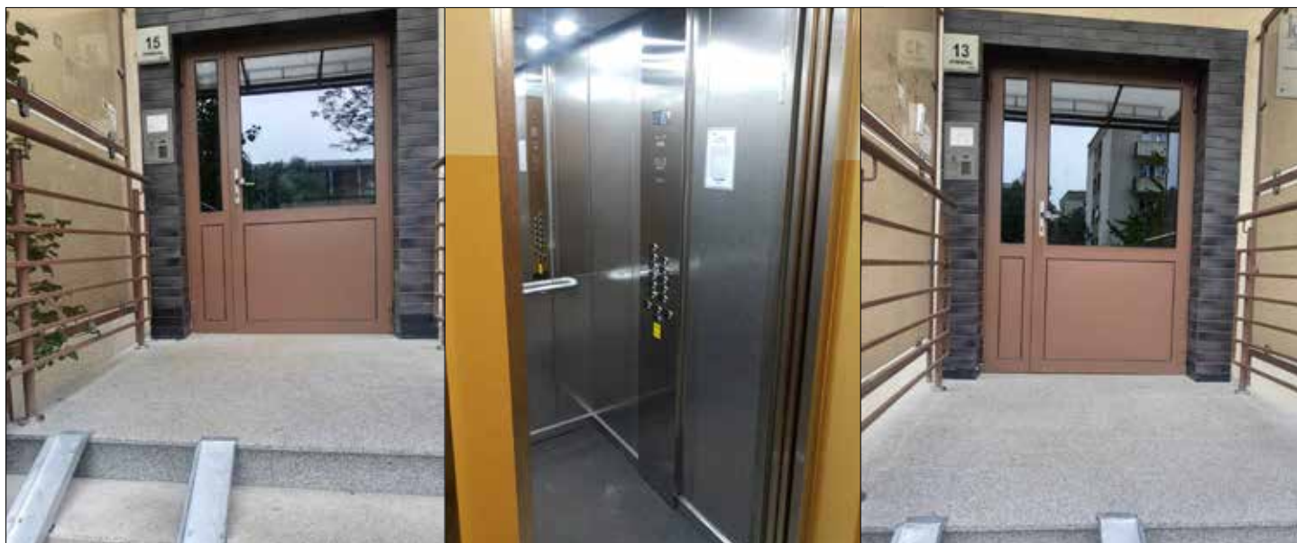
Zakończone remonty w budynku osiedla Śródmieście przy ul. Rybnickiej 13 - 15 - 17: podesty schodów i dźwig osobowy
