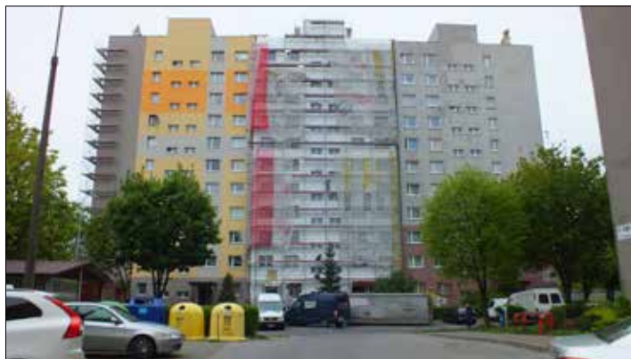
Skalę wiosennych prac na Giszowcu najlepiej obrazuje ten budynek przy ul. Wojciecha 51- 51b: 1/3 po termomodernizacji, środkowa część w trakcie, a ostatnia „tercja” oczekuje na nią
